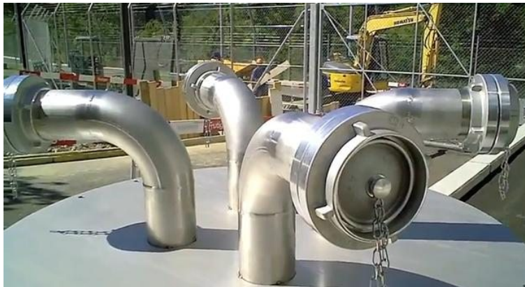
Abb. Alle vier Einspeisestutzen sind an einer einzigen Einspeisestelle angebracht und können damit durch Beschädigung oder Unzugänglichkeit auf einen Schlag ausfallen (Common Cause Failure)
