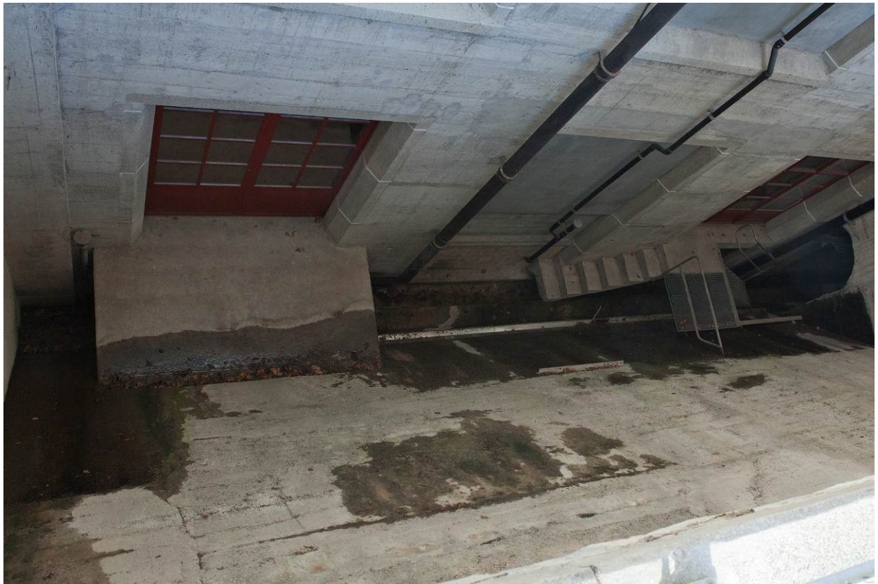
Figure 5: Wasserdurchdringung klar lokalisiert an Arbeitsfugen (Mauer beim Maschinenhaus). Foto: M. Kühni
